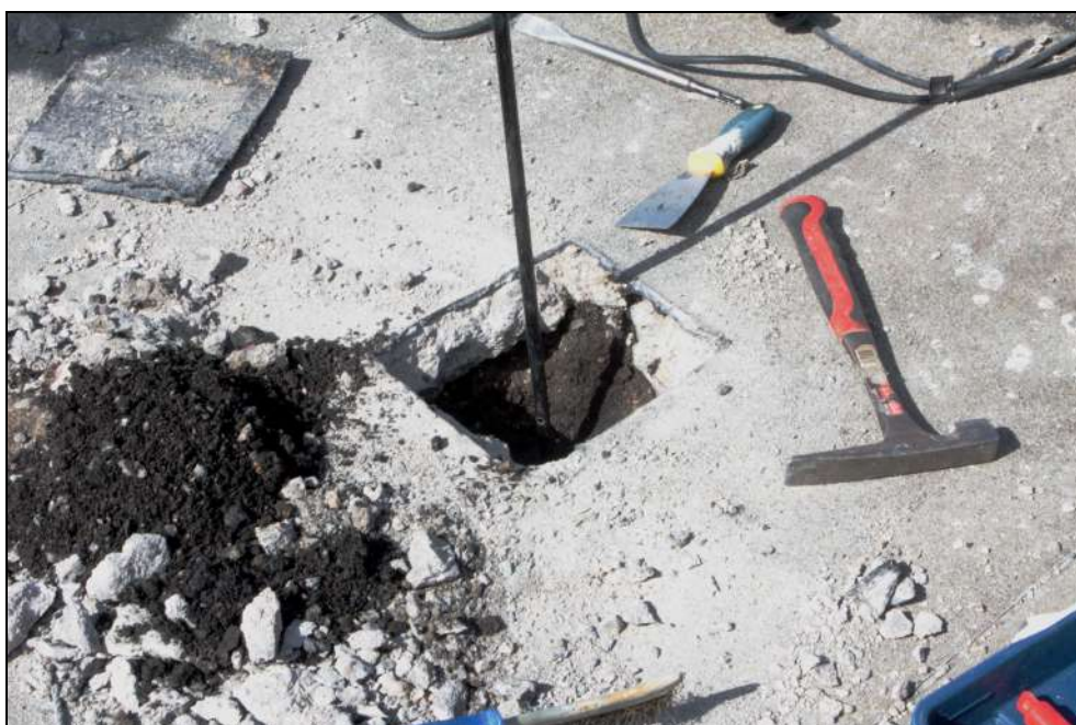
Рисунок 7. «Г-Д»/«9-10» Утеплитель-шлак при вскрытии во влажном состоянии.
