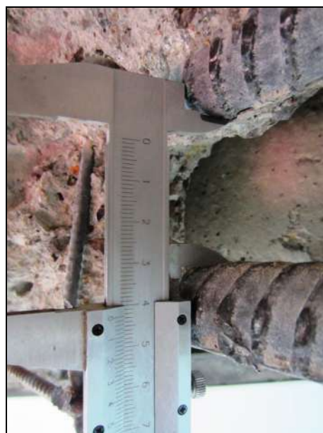
Рисунок 5. При вскрытии поверхность арматуры чистая. Глубина нейтрализации бетона не превышает половины толщины защитного слоя. Арматура габаритный \text{Ø} 27 .
