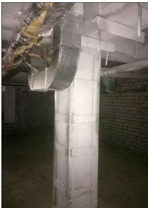
Рисунок 1. Незначительные повреждения в виде отдельных трещин, редких поверхностных сколов. Наличие усиления конструкций каркаса согласно проекту ТОО «Караганда Техно Сервис» (см. лист 4, 5 114-ШИ-07/14-1-КЖ).
