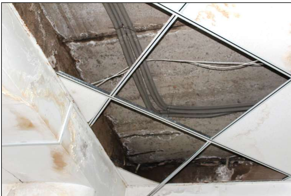
Рисунок 12. «Г/1»/«12». Фильтрации влаги в местах сопряжения плит и наружных стен.
